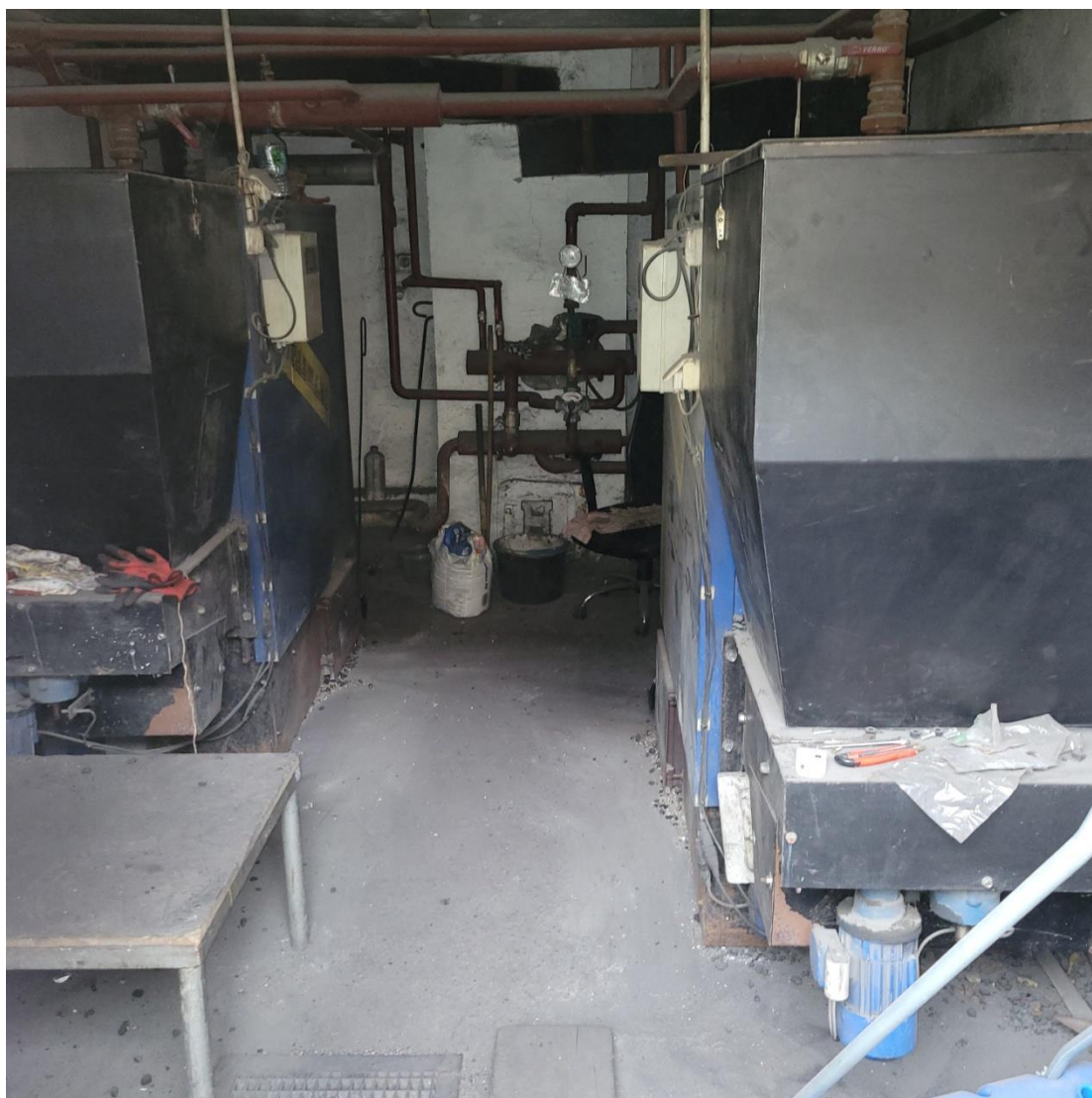
Fot. 2 Widok istniejącej kotłowni w budynku administracji publicznej i archiwum.
