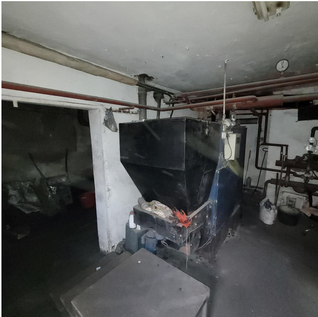
Fot. 3 Widok istniejącej kotłowni w budynku administracji publicznej i archiwum
